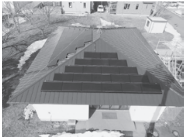
北2丁目コミュニティ会館の太陽光パネル (定格出力9.9kW)
