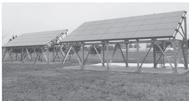
西5丁目地区内に設置された太陽光パネル。
