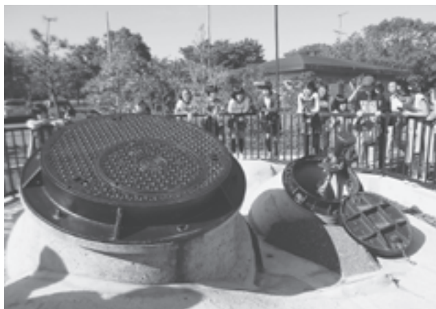
液状化現場の視察
