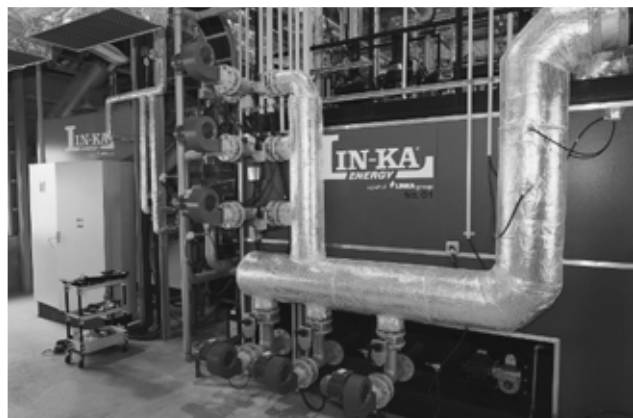
もみ殻バイオマスボイラー
