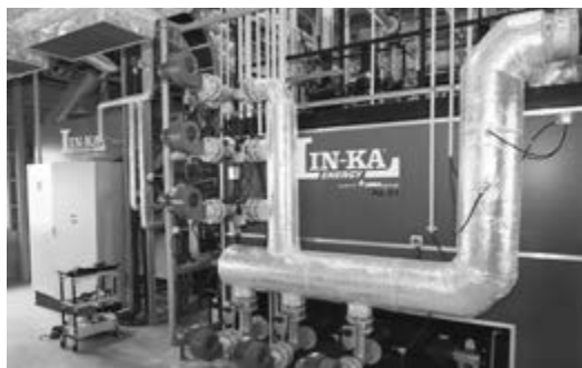
稼働が遅れたもみ殻熱供給事業（ボイラー）
