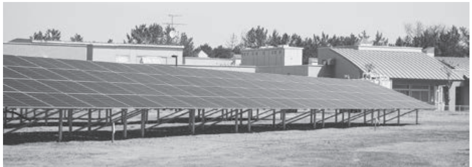
ひだまり苑に設置された太陽光パネル
