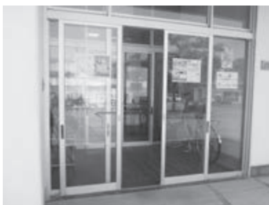
保健センター内に設置予定
