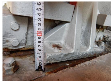
支承のボルトの脱落・傾斜
