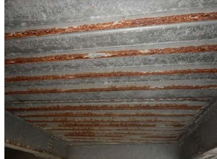
鋼床版の腐食
