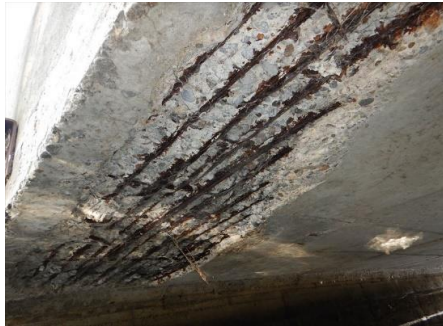
床版の広範囲に亘る鉄筋露出
