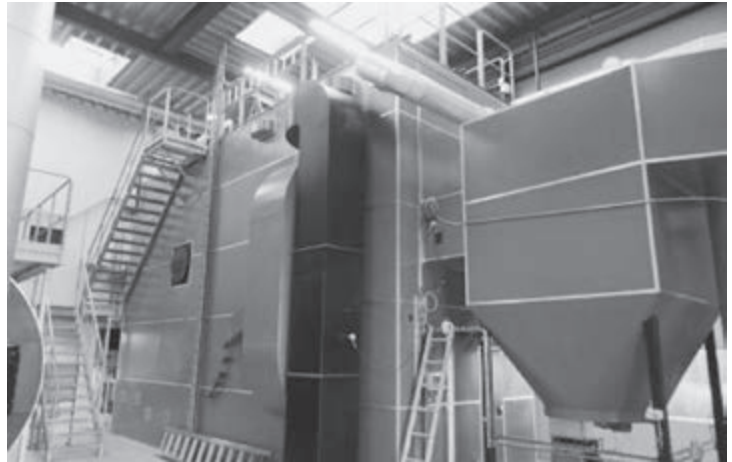
デンマーク製バイオマスボイラー
