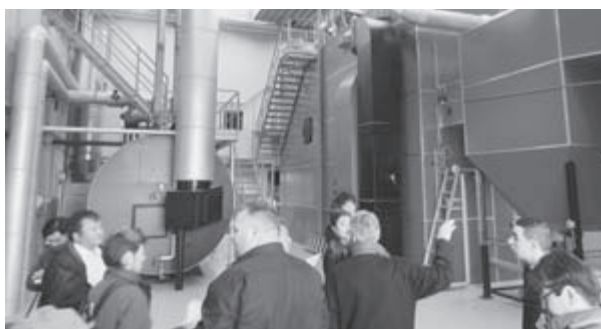
デンマーク視察 ボイラー設備
