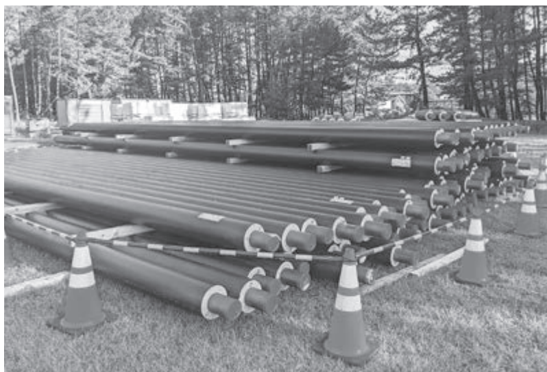
ようやくスタートした脱炭素事業の行方は（村内に敷設する熱導管）
